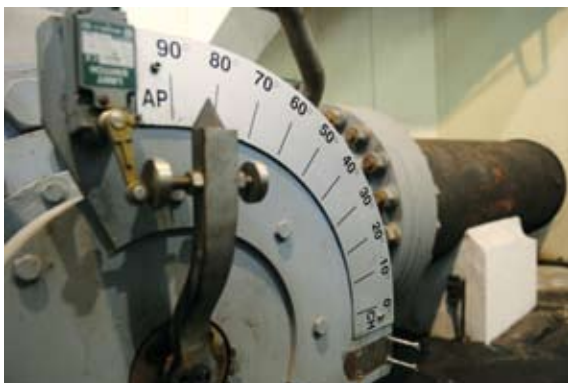
Ingranaggi in Centrale.
