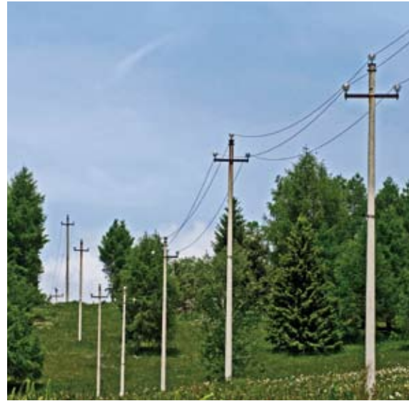
Impianti "vie" di elettricità.
